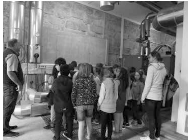
Im Inneren der Scheune sehen die Schüler, dass auch Wärmeleitungen zu ihrer Schule verlaufen.
